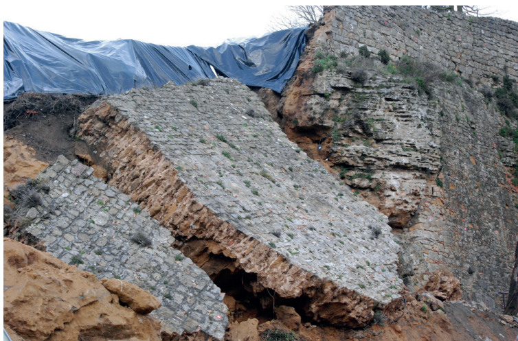
Fig. 6: Volterra 3 marzo 2014: lo sperone di Piazza Martiri della Libertà è crollato (© Aiuta Volterra www.aiutavolterra.it )
