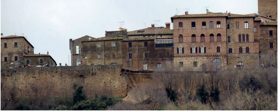
Fig. 3: Volterra, veduta panoramica del tratto crollato in via Lungo le Mura (© Aiuta Volterra www.aiutavolterra.it )
