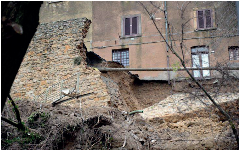
Fig. 2: Volterra, frana di Via Lungo le Mura vista dal sottostante viale Trento e Trieste (© Aiuta Volterra www.aiutavolterra.it )
